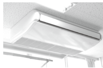
▲教室のエアコン室内機と室外機
